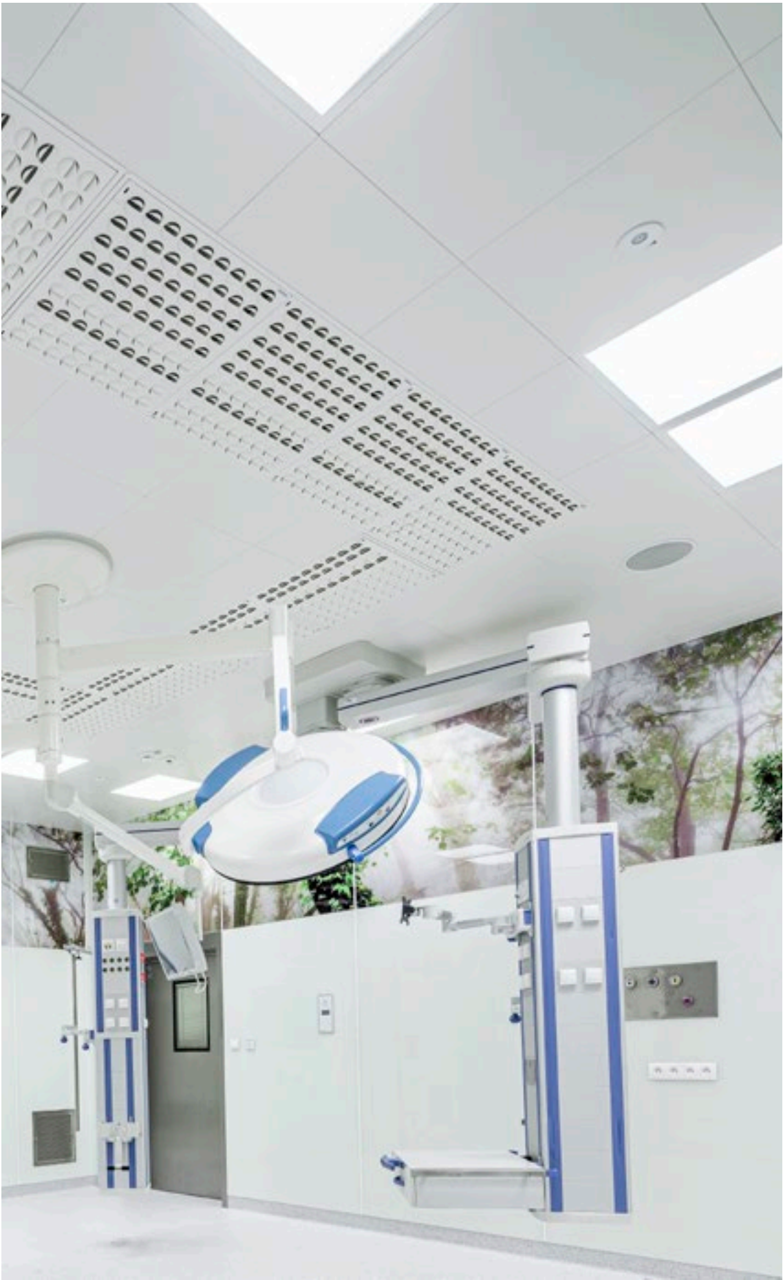
Oprawy Lumedic w szpitalu
