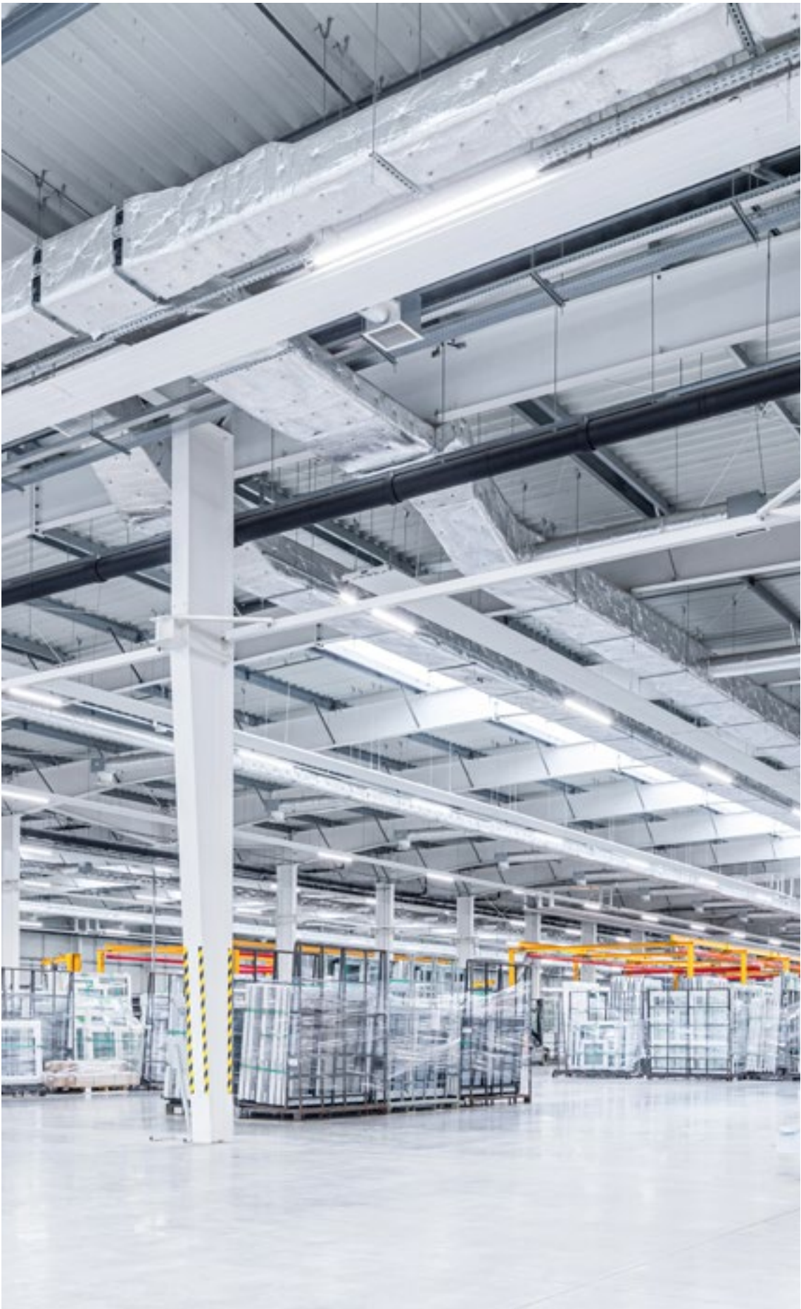
Zastosowanie lamp Linero LED w hali magazynowej
